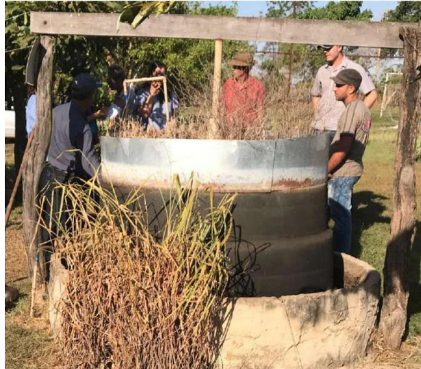
Figura 9 - Biodigestor “Sertanejo” com cúpula flutuante de fibra, Itaberaí - GO.
