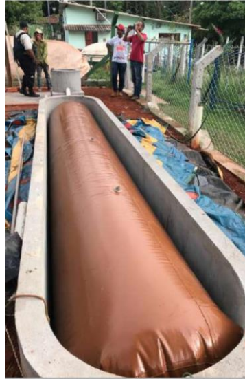
Figura 32 - Biodigestor tubular implementado no BiogasLab IFG-UFG, Goiânia – GO.
