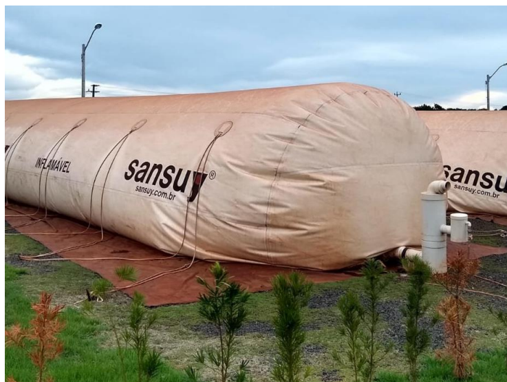
Figura 20 - Reservatório tipo “Gas bag” no Projeto Entre Rios do Oeste - Paraná.
