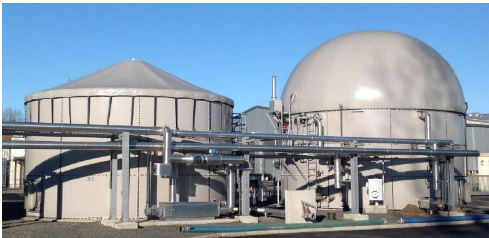
Figura 16 - Biodigestores industriais de cúpula flexível. Biorreatores tipo "CSTR".
