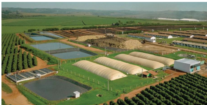
Figura 12 – Série de biodigestores tipo lagoa coberta para tratamento de efluentes suínos, 500 KWel.
