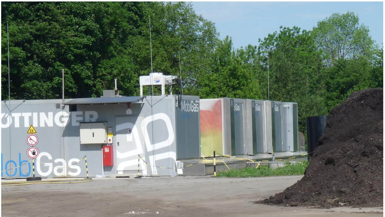
Figura 20: Reatores de fermentação a seca tipo “contêiner” com digestado Braunau, Áustria.
